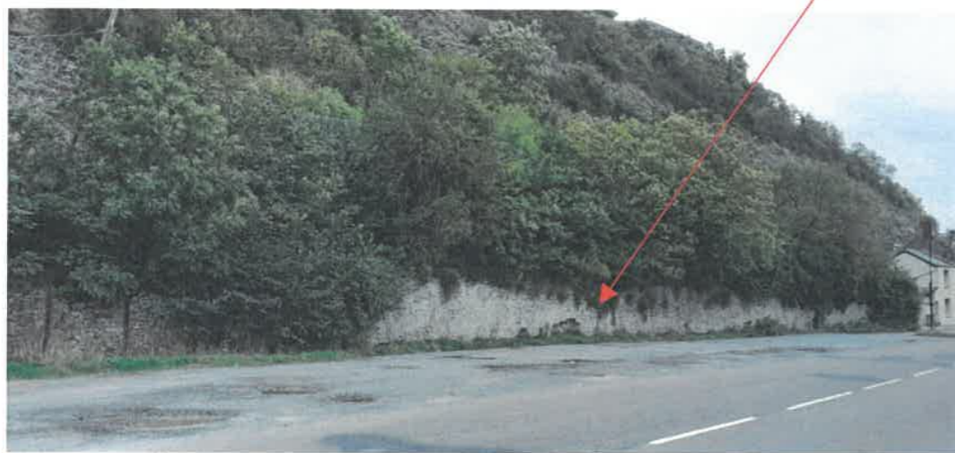
zone d'intervention projetée au droit de mur de soutènement et se prolongeant le long du filet anti-chute.
